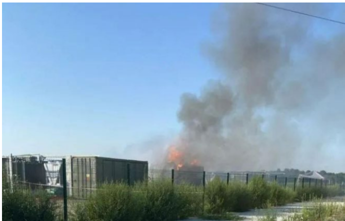
2023.08 法国西南部Saucats 105MW 锂电池储能电站储能柜发生火灾
