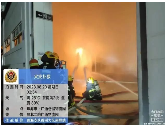
2023.08 珠海物流园储能柜发生火灾
