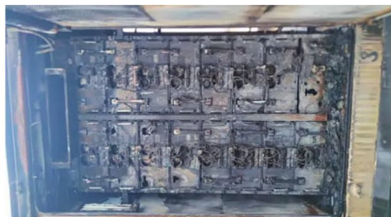
2024.05 海南70MW锂电池储能电站起火
