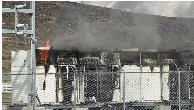
2023.10 美国爱荷华州 2MW储能系统储 能柜发生起火
