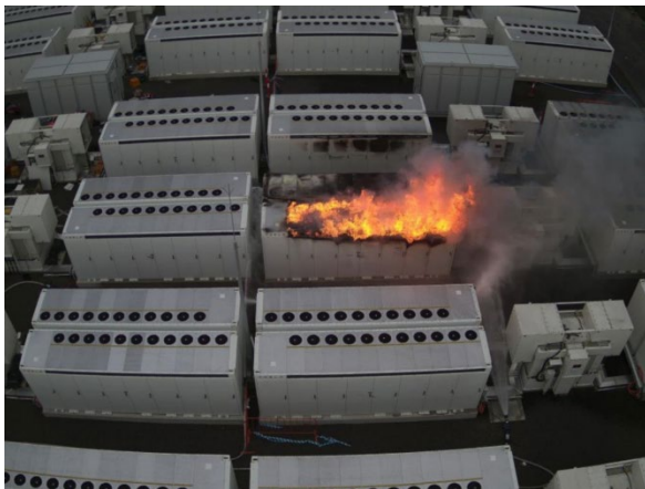
2023.09 澳大利亚昆士兰州 50MW/100MWh 锂电池储能电站发生火灾
